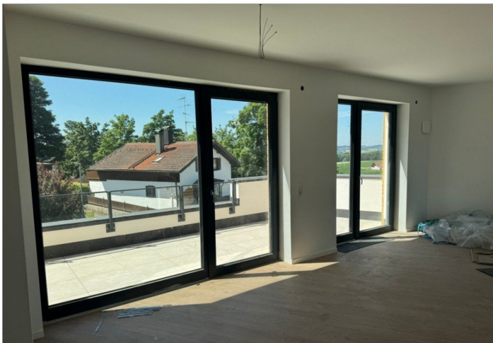
Wohnbereich mit Lüftungsanlage
