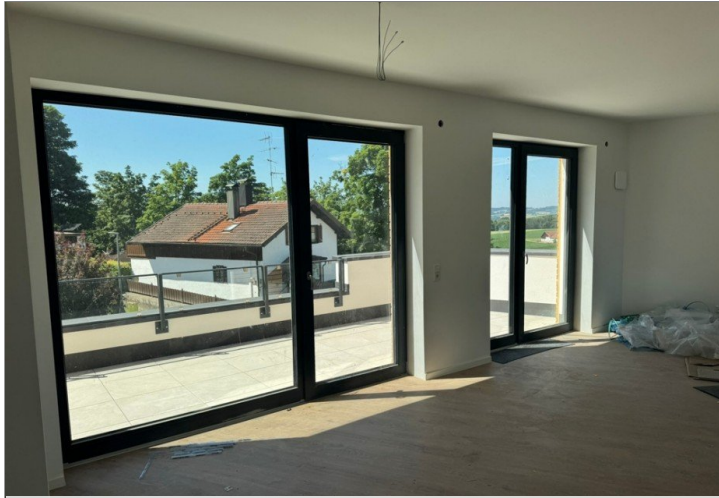
Wohnbereich mit Lüftungsanlage
