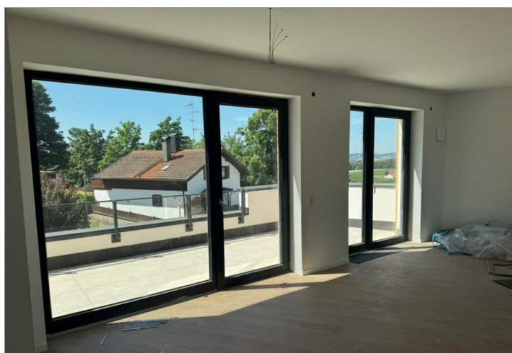
Wohnbereich mit Lüftungsanlage
